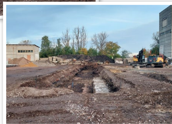
Blick auf die im Bau befindliche Unterkonstruktion der Lärmschutzwand, die gleichzeitig als Trennwand für die Haufwerke dienen wird
